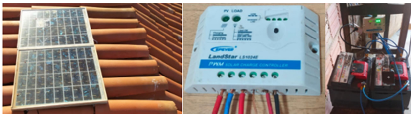
Figura 9 – Painéis fotovoltaicos, controlador de carregamento de bateria e baterias estacionárias Fonte: Autor (2022)
