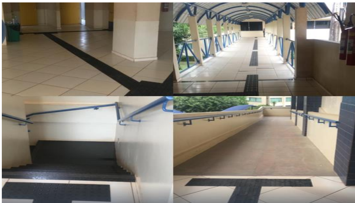
Figura 5: Adequações realizadas no educandário, conforme a NBR 9050.
