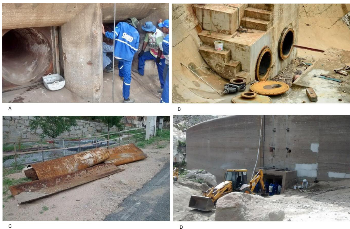
Figura 59: Reparos hidromecânicos no maciço.
