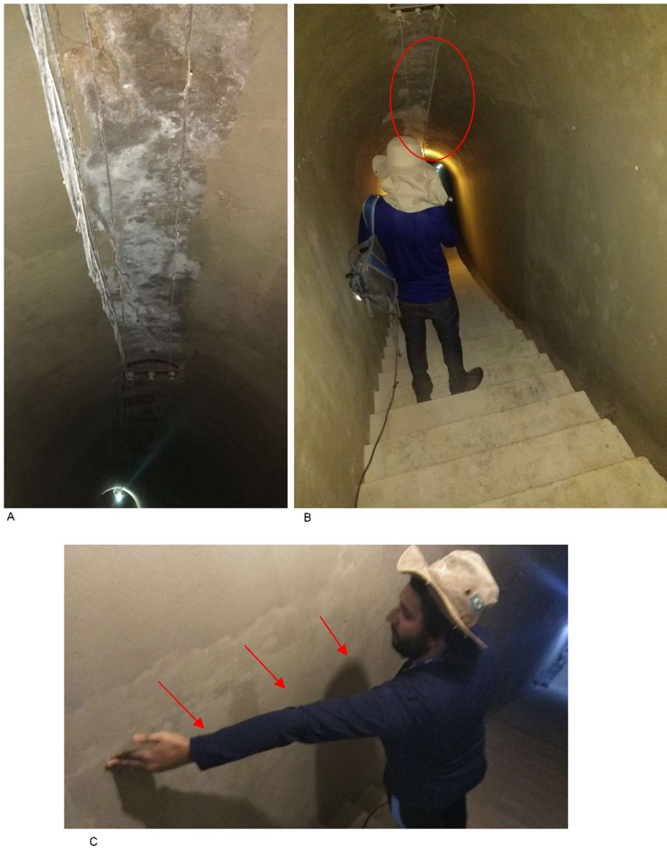
Figura 65: Carbonatação no teto da galeria.
