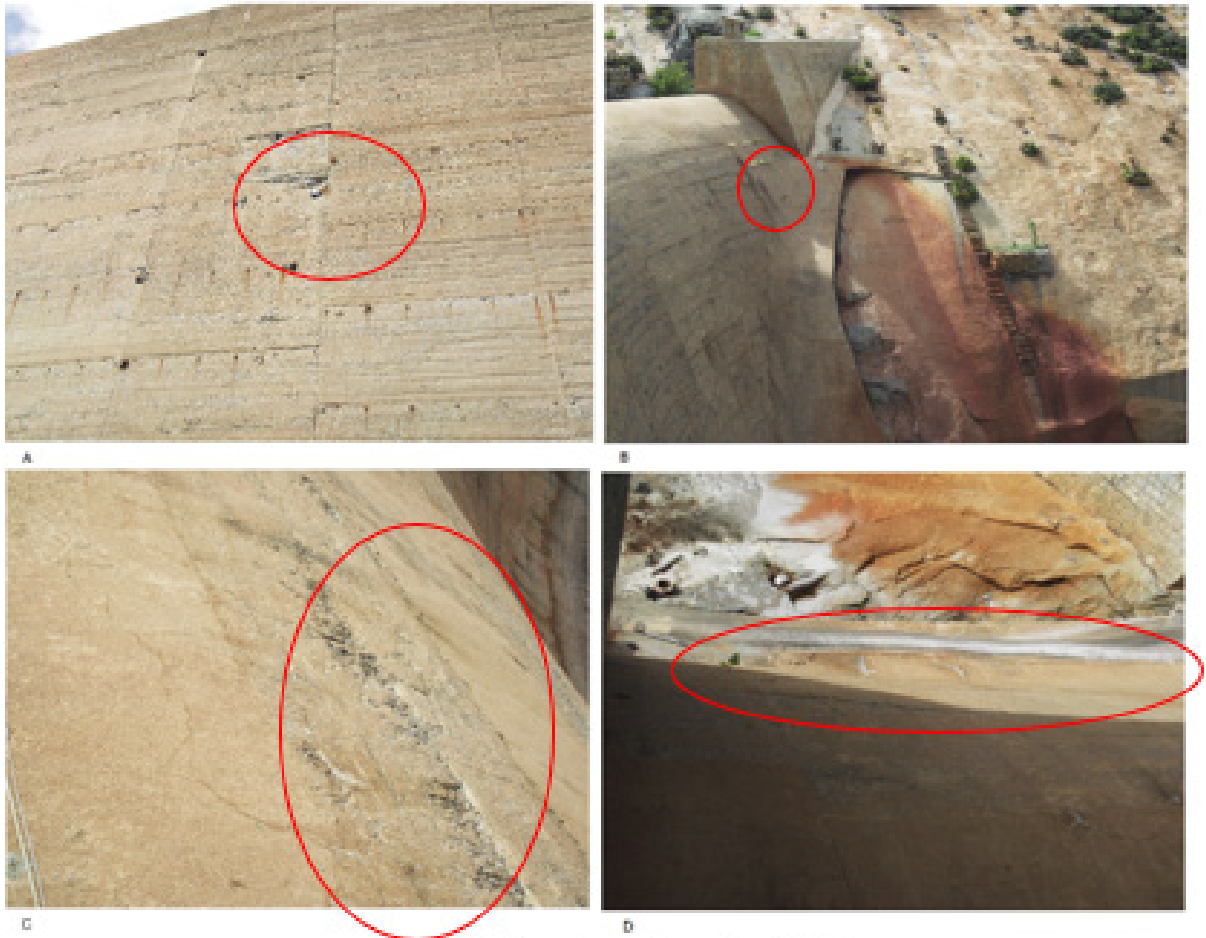
Figura 62: Anomalias nos paramentos.
