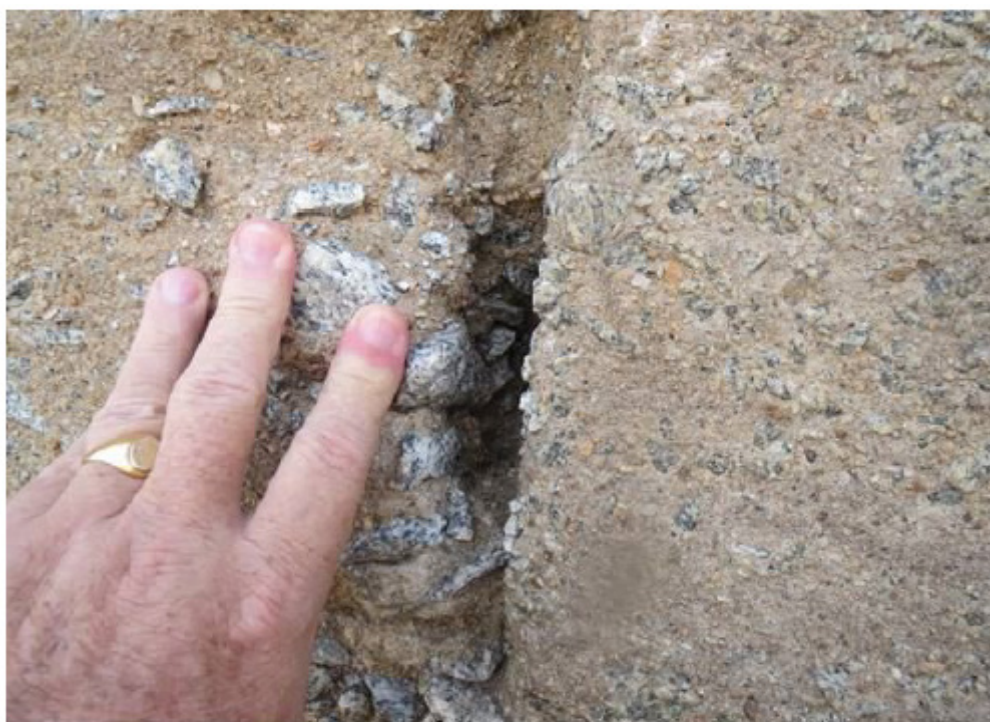
Figura 56: Desagregação do concreto.
