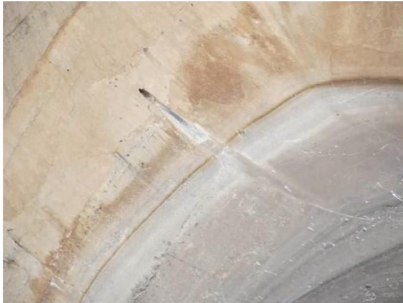
Figura 54: Fissura no vertedouro.
