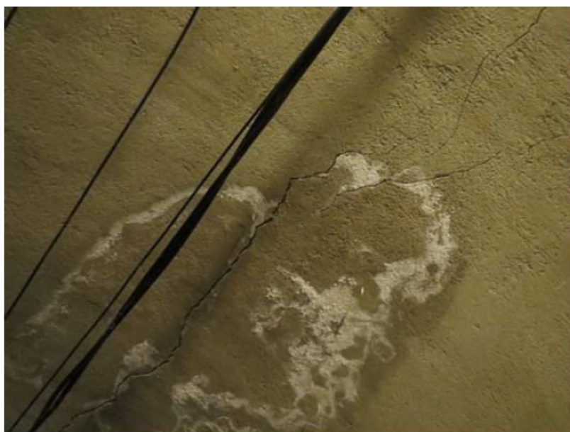
Figura 49: Processo de lixiviação no teto da galeria.
