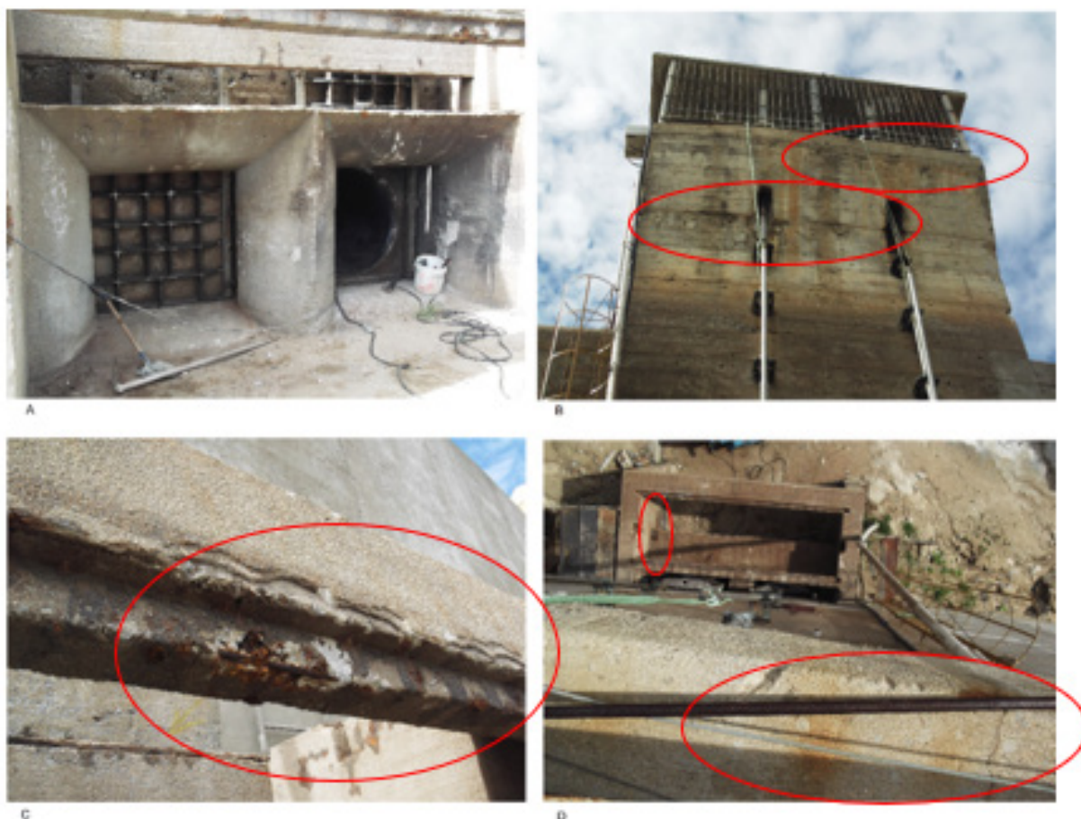
Figura 61: Anomalias nos equipamentos hidromecânicos.
