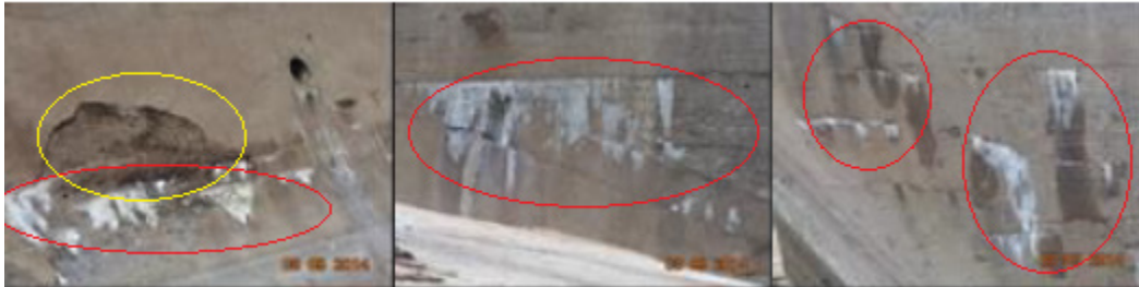
Figura 55: Fuga de água no paramento de jusante.
