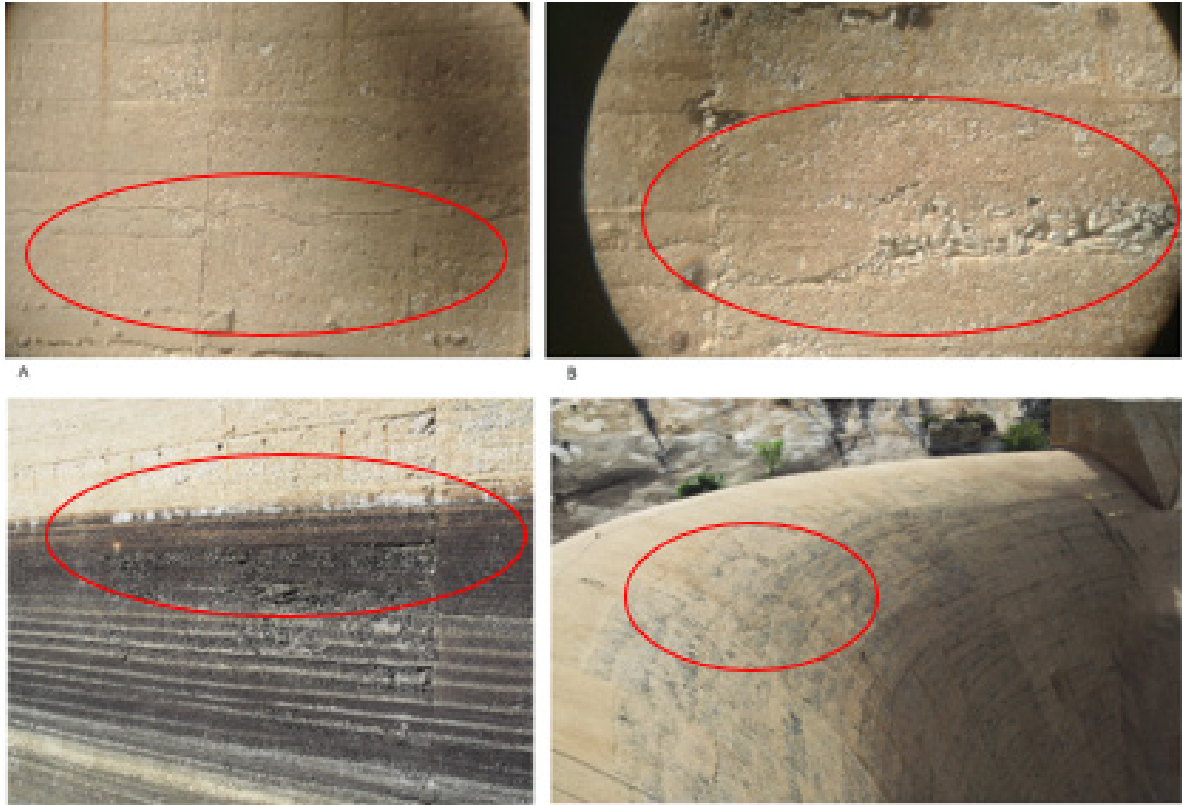
Figura 63: Patologias nos paramentos do maciço.
