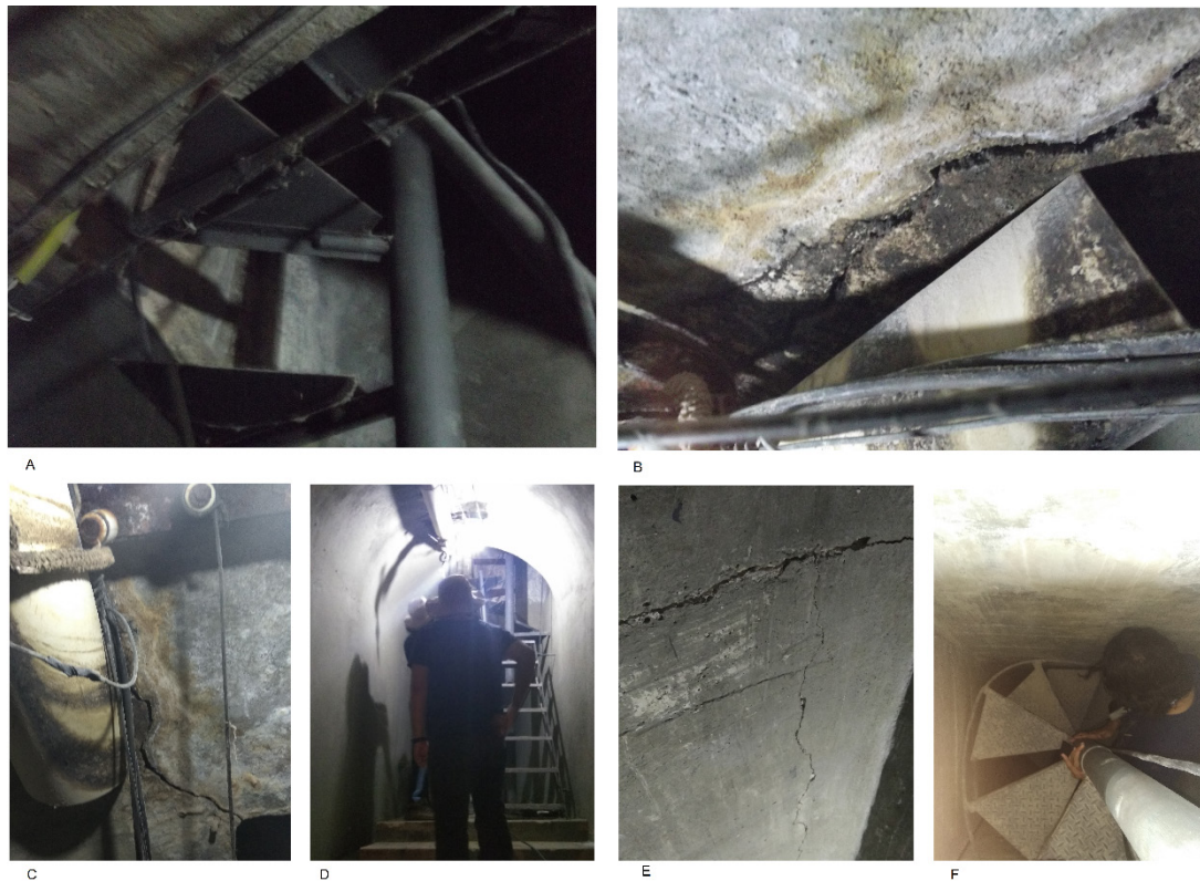
Figura 64: Patologias na galeria e acesso a tomada d'água.
