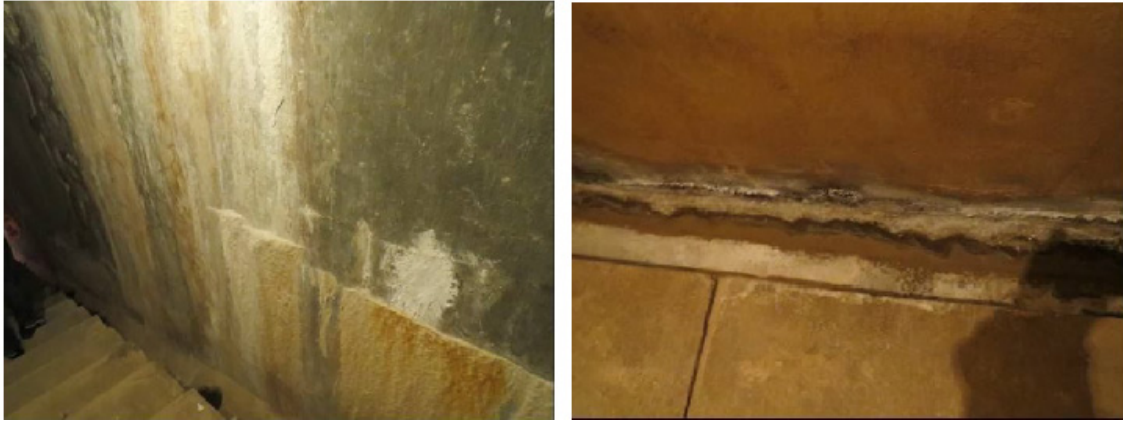
Figura 52: Patologias estruturais nos drenos da galeria.
