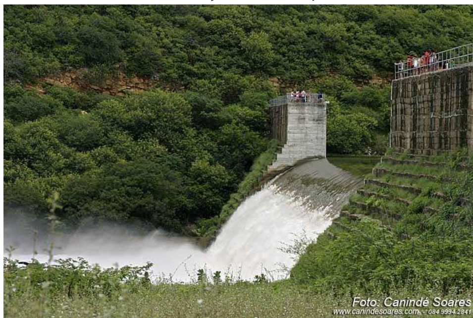
Figura 41: Barragem do tipo gravidade com compactação de concreto a rolo – Barragem Passagem das Traíras, em Jardim do Seridó/RN.
