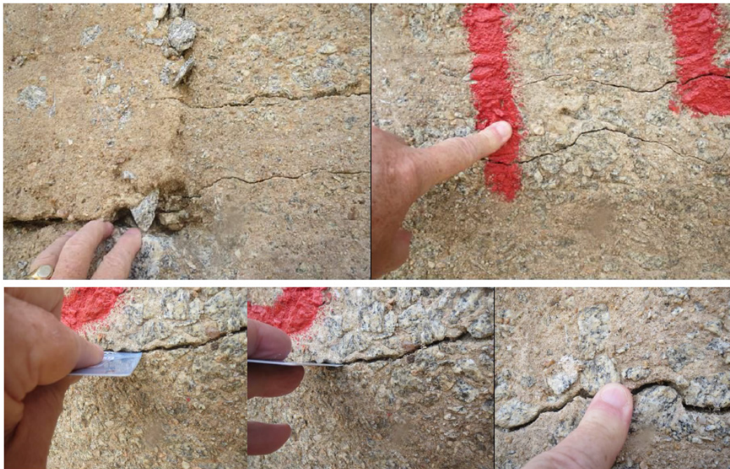
Figura 53: Fissuras horizontais nos paramentos
