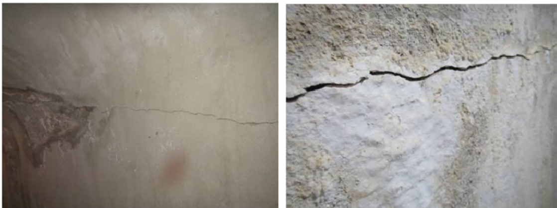
Figura 48: Rachadura na entre o teto da galeria e a parede do paramento de jusante.
