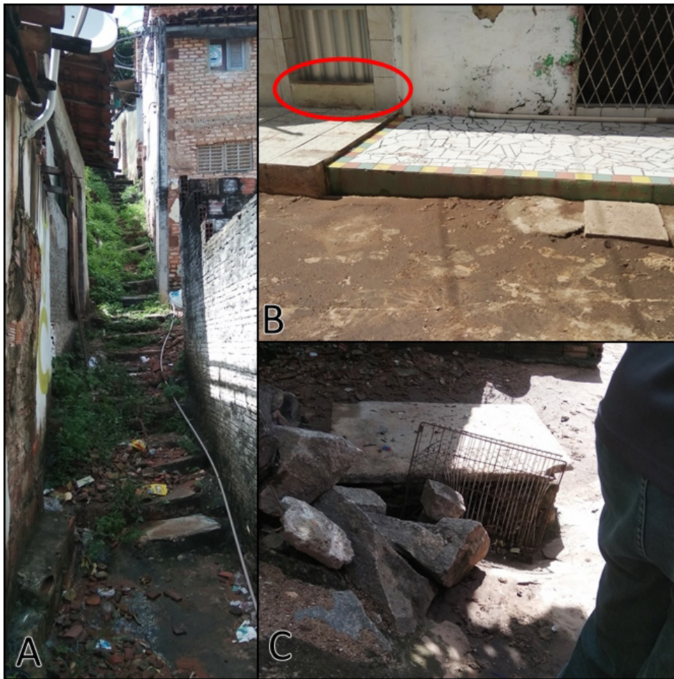
Figura 25 - Problemas no Setor 4 da Comunidade do Jacó.
