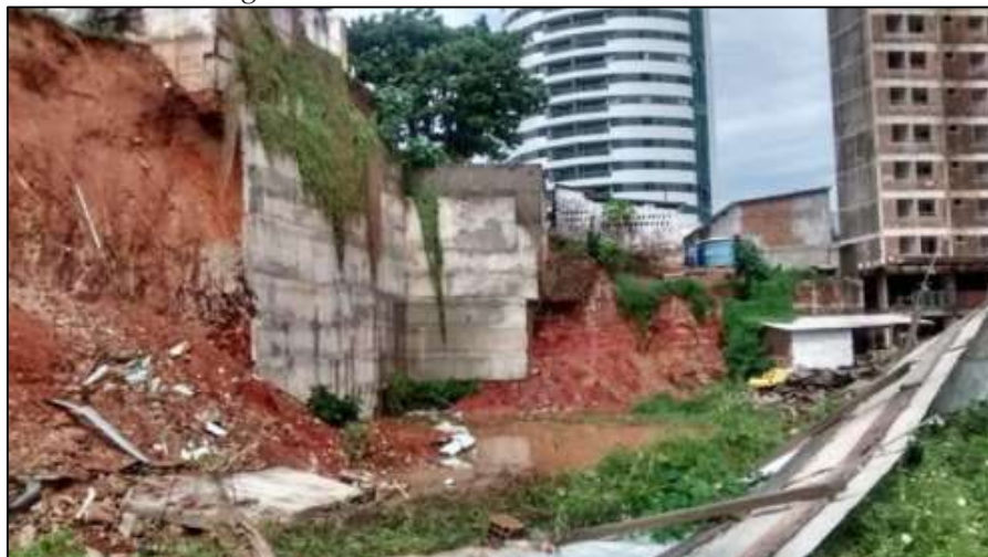
Figura 15 - Muro de arrimo desaba em 2016.
